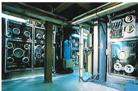
Usine MELOX – bâtiment de fabrication des combustibles MOX – confinement en boîtes à gants des équipements de préparation du mélange des poudres d'oxydes d'uranium et de plutonium
