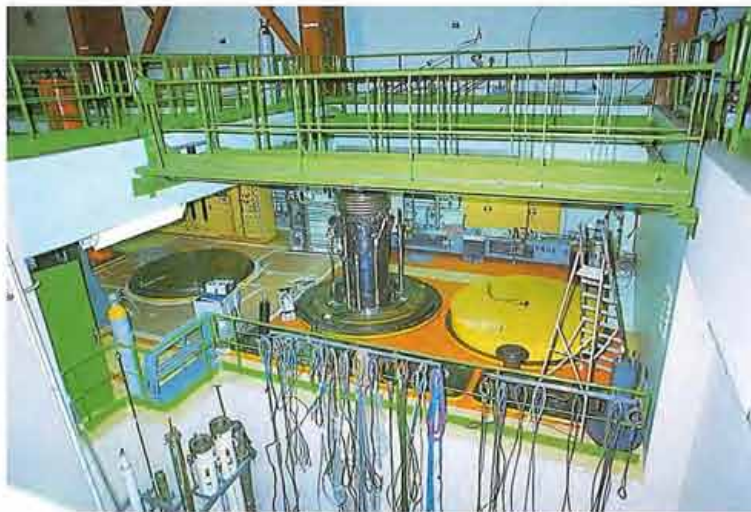
Phénix – Arrêt de tranche 1999, hall du réacteur – sur le site du CEA de Cadarache
