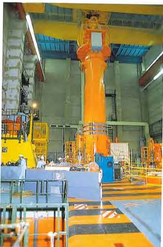
Phénix – Arrêt de tranche 1999, hall du réacteur – sur le site du CEA de Cadarache
