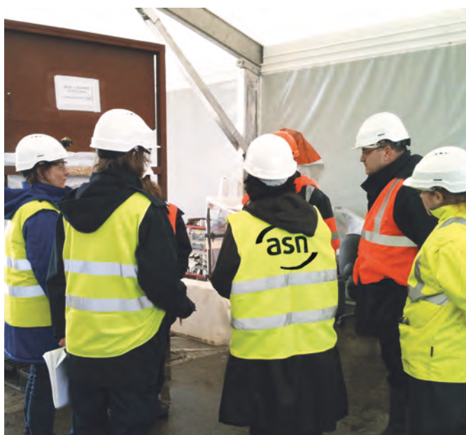
Inspection de l'ASN sur le chantier d'assainissement des sols du pourtour de la STE de Brennilis, en 2014.
