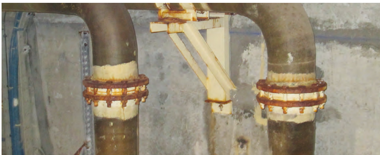
Effet du vieillissement : oxydation sur canalisation.
