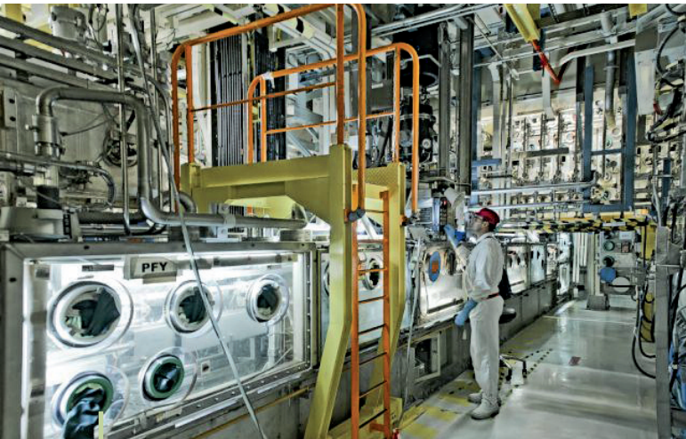
Boîtes à gants de l'installation MELOX à Marcoule
