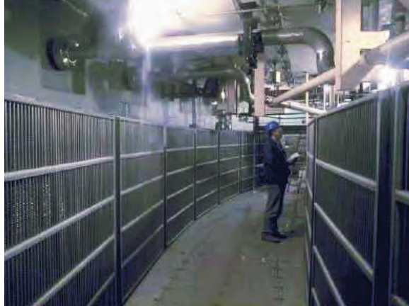
Puisards d'un réacteur du palier N4
