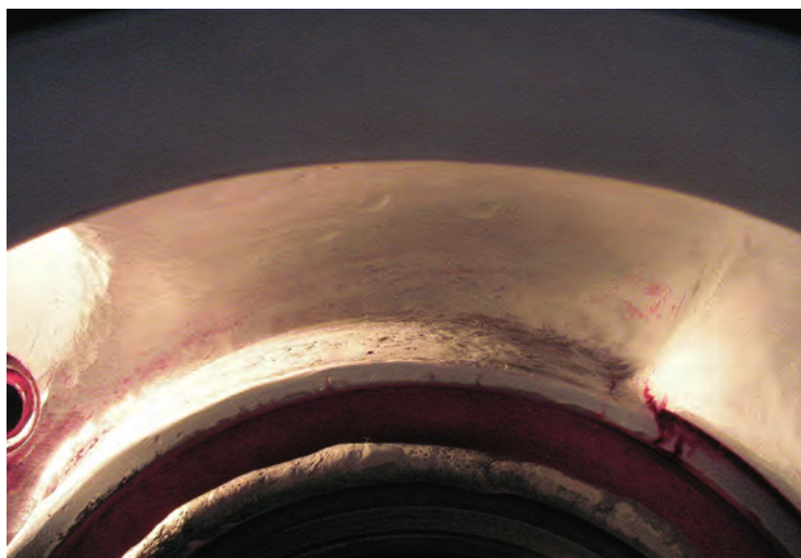
Fatigue thermique sur le corps de la vanne ASG 135 VV de Fessenheim 2
