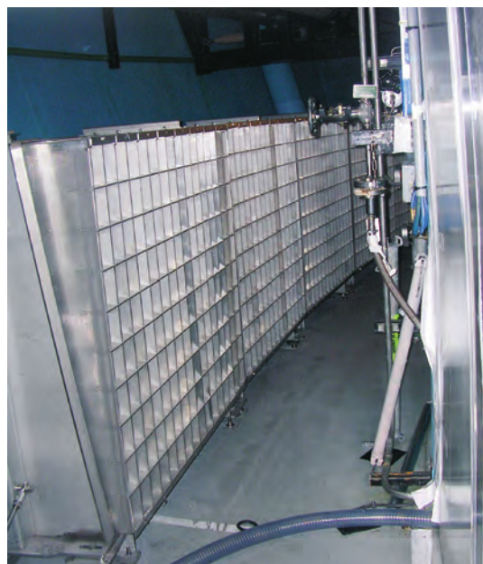
Nouveaux puisards mis en place par EDF en 2005
