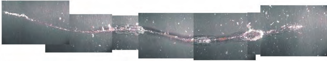
Vue face interne du tube fissuré
