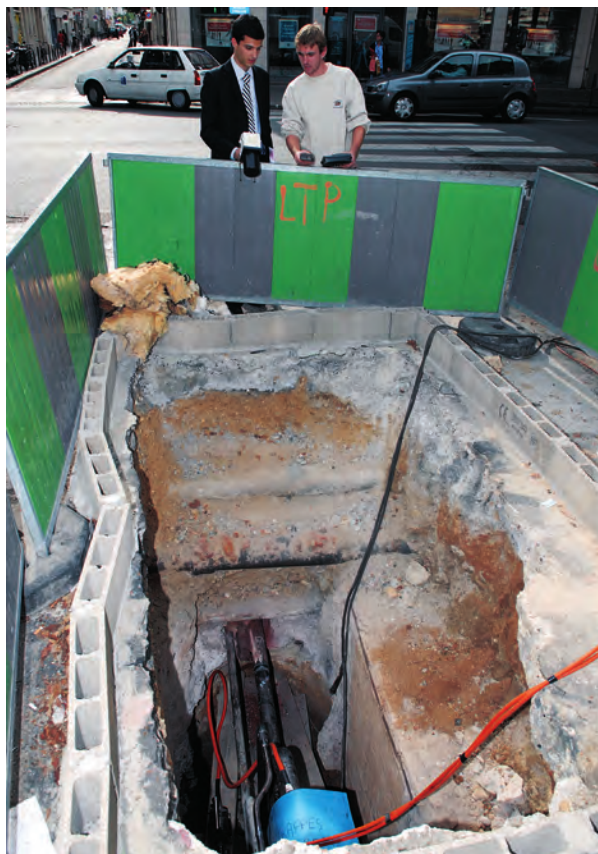
Contrôle de débit de dose sur un chantier de gammagraphie lors d'une inspection de la radioprotection
