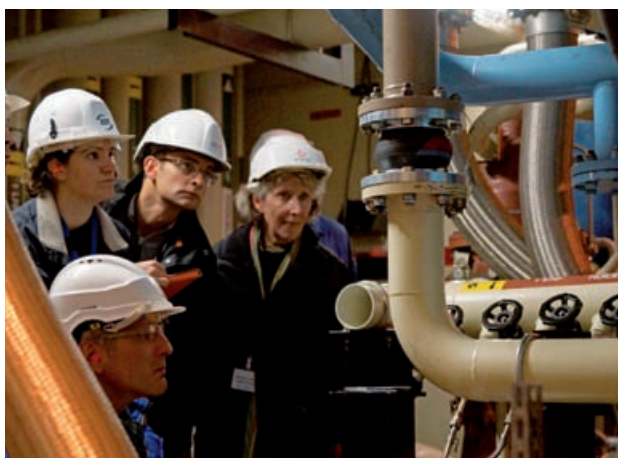
Inspection de l'ASN accompagnée par un député européen « Suivi des engagements – Récolement inspection Fukushima » à la centrale nucléaire de Civaux : contrôle des tuyauteries et des capteurs dans des groupes électrogènes diesels de la centrale – Octobre 2012
