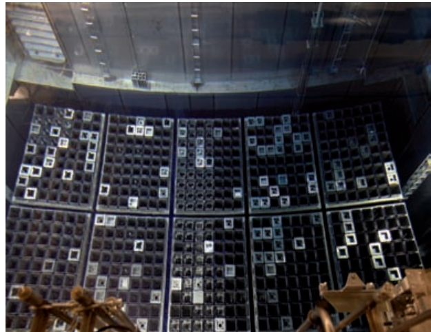
Piscine d'entreposage du combustible lors de la visite décennale de l'unité de production n°3 de la centrale nucléaire de Cattenom - Février 2011
