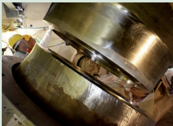
Opération d'accostage du générateur de vapeur avec la tuyauterie primaire côté branche chaude
