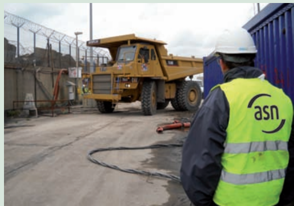
Inspection des travaux d'enlèvement du bouchon entre le canal d'amenée d'eau de mer du réacteur 2 et celui du réacteur 3 – Octobre 2012
