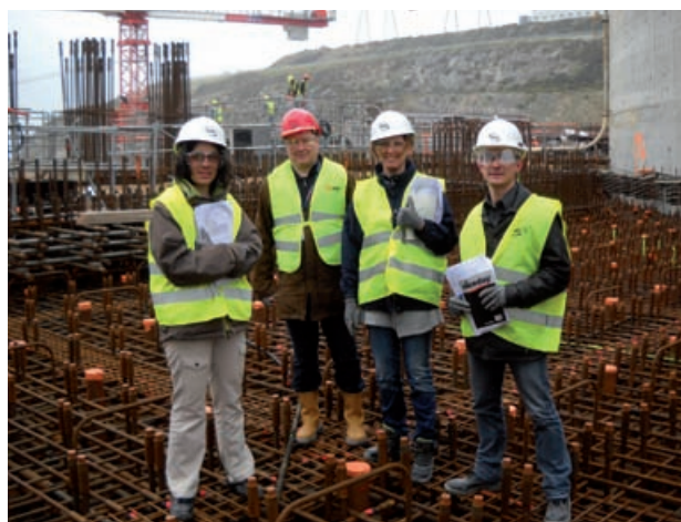
Inspection de l'ASN avec l'Autorité de sûreté finlandaise (STUK) du chantier de l'EPR à Flamanville – Mars 2012
