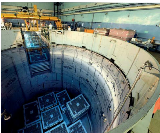
Les combustibles irradiés issus des réacteurs d'étude du CEA ont été entreposés dans cette piscine depuis 1980. Ils sont en cours d'évacuation et de traitement.
