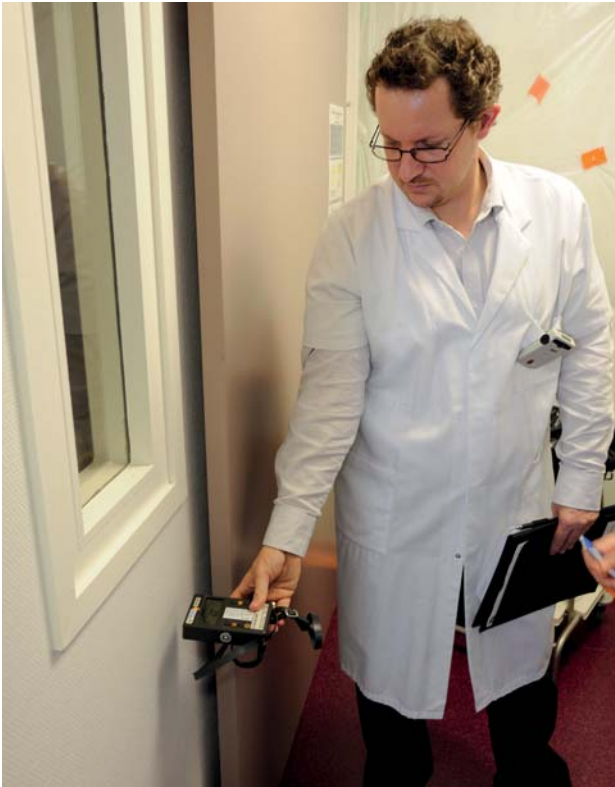
Contrôle de l'ASN des travaux d'aménagement des locaux du service de médecine nucléaire du centre Oscar Lambret à Lille – Novembre 2011
