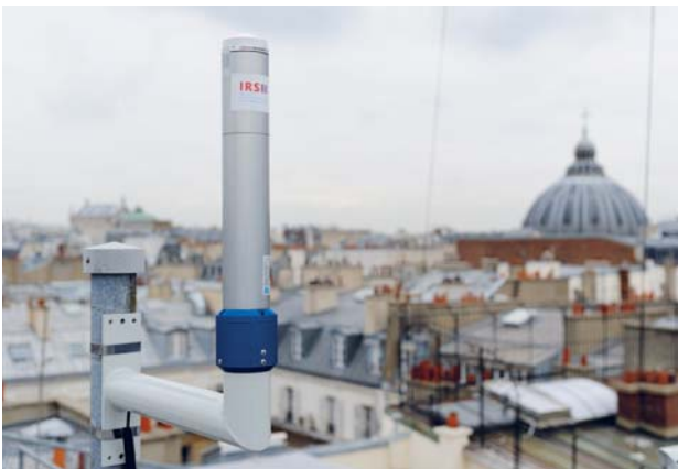
Balise IRSN nouvelle génération du réseau Télecay, dispositif de surveillance de rayonnement gamma ambiant en France installé à Paris sur le toit de l'état-major de la Marine
