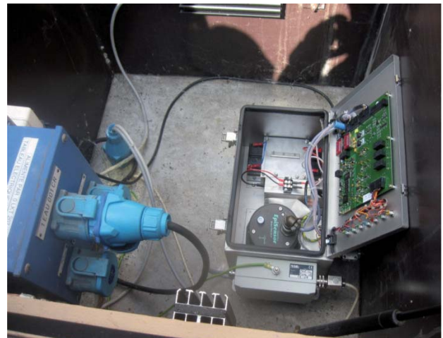
Vue d'un équipement de surveillance sismique (accéléromètre) en place dans une centrale
