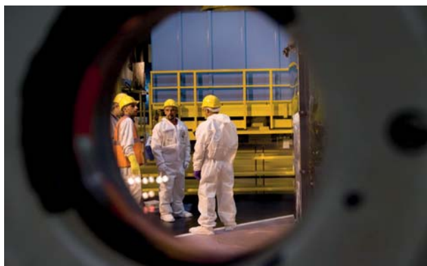
Maintenance dans le bâtiment réacteur sur le site de Flamanville pendant l'arrêt du réacteur 2
