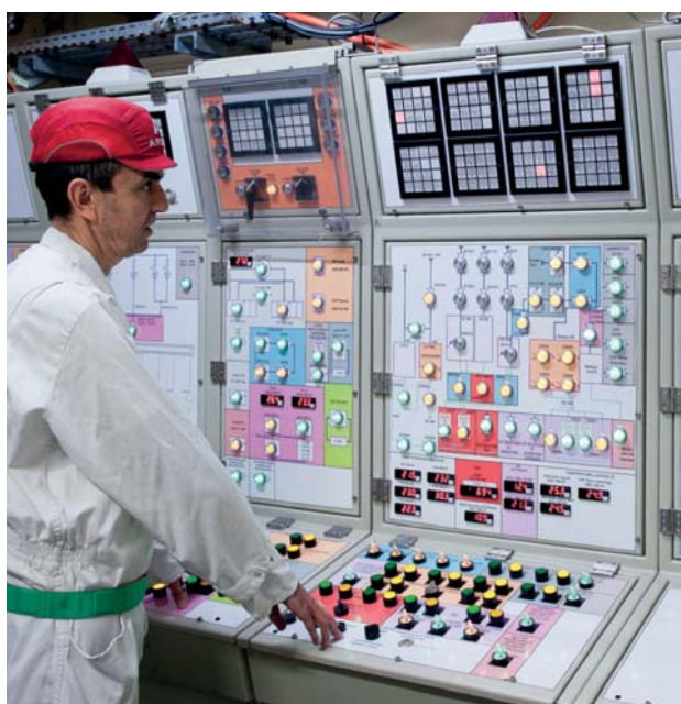
Panneau de conduite de sauvegarde de l'usine MÉLOX. Le responsable d'exploitation « utilités » supervise les contrôles et essais périodiques.
