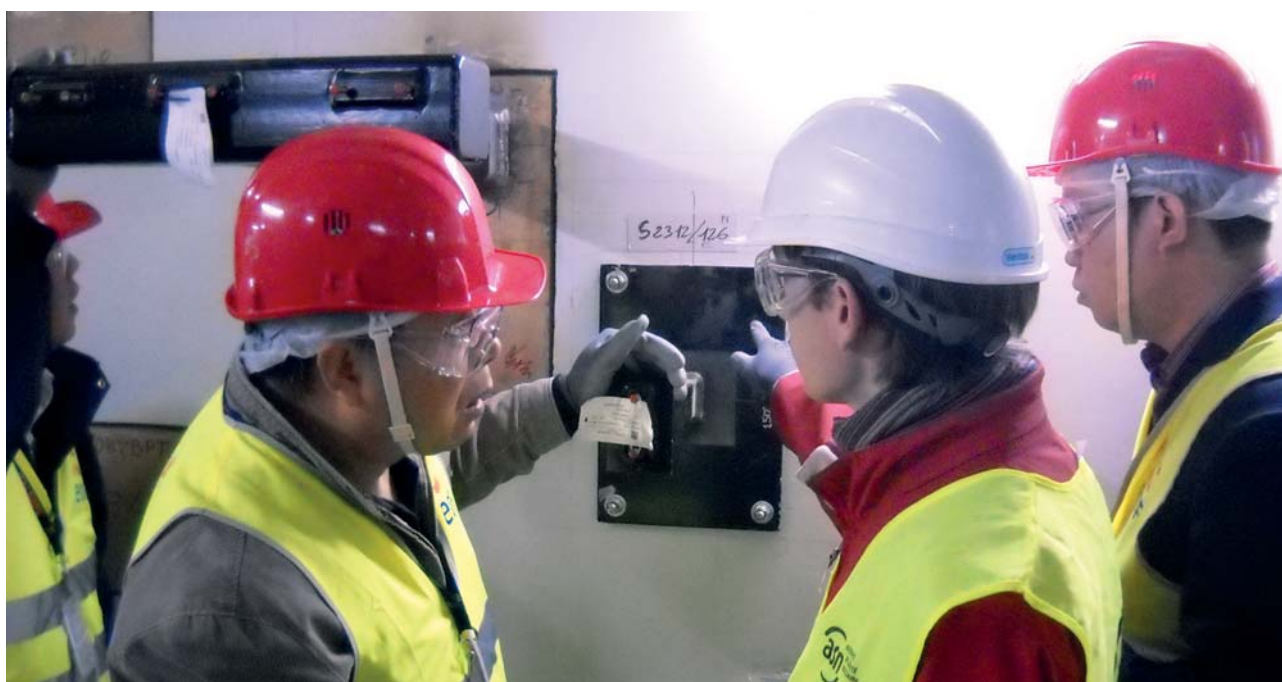
Visite du chantier de construction du réacteur EPR de Flamanville en compagnie de l'Autorité de sûreté nucléaire chinoise – Novembre 2011
