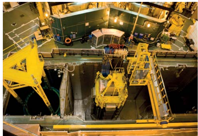
Vue sur la PMC (Piscine Manutention Combustible) de la tranche 2 de la centrale nucléaire de Belleville-sur-Loire lors de la visite décennale – Juin 2009
