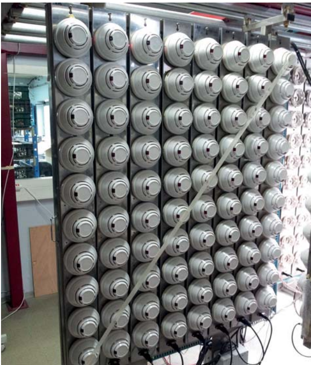
Reconditionnement de détecteurs de fumées
