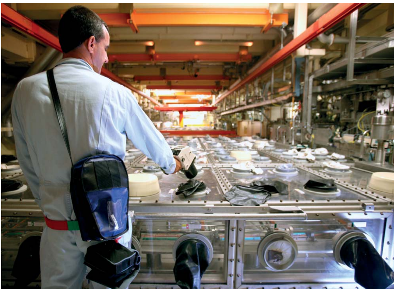
Contrôle de radioprotection sur des boîtes à gants en salle gainage dans l'usine de fabrication de combustible MOX de Bagnols-sur-Cèze
