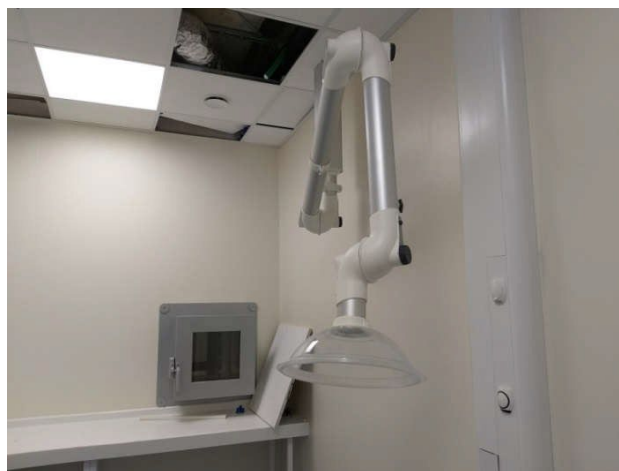
Fig. 3 – Cône d'aspiration des aérosols radioactifs en salle d'injection IR2/02/073
