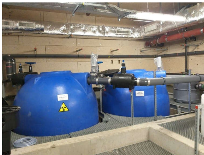
Fig. 12 – Fosses septiques de l'unité de médecine nucléaire
