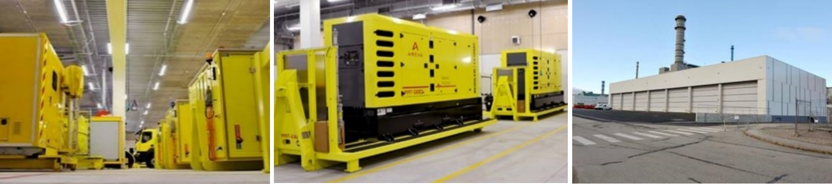
De gauche à droite : Entreposage du matériel d'intervention, Groupe électrogènes mobiles, Bâtiment d'entreposage
