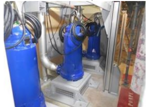
Pompes sous bassin
