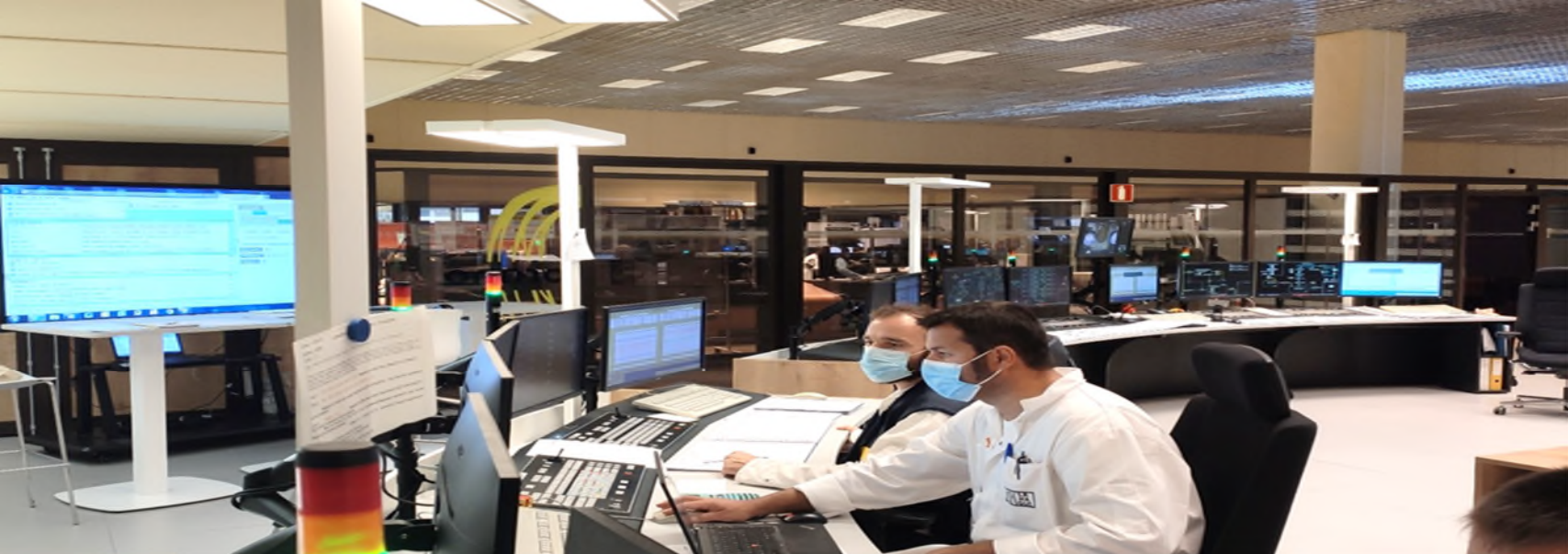
Salle de conduite centralisée (située dans le bâtiment central)
