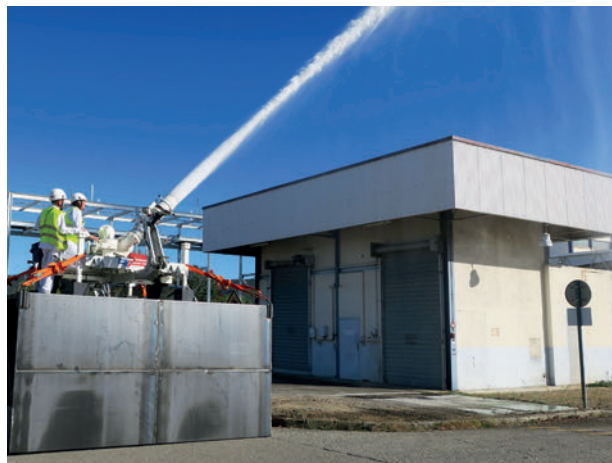
Renfort des moyens d'aspersion de Comurhex à la suite de l'événement déclaré le 22 août 2017.
