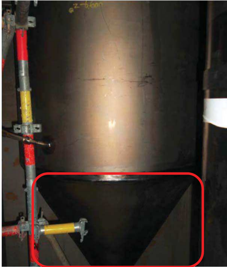
Localisation de mesures d'épaisseur sur le cône en dessous du bas de la virole de la colonne 4140-30 de T2
