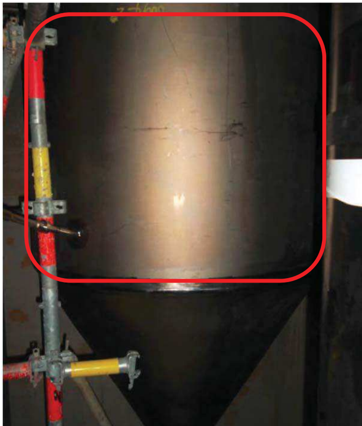
Localisation de mesures d'épaisseur sur le bas de la virole de la colonne 4140-30 de T2
