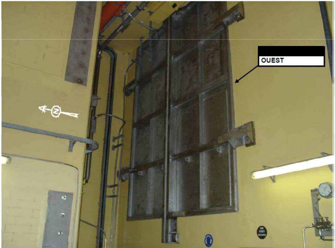
Figure 6 – Mur de baryte
