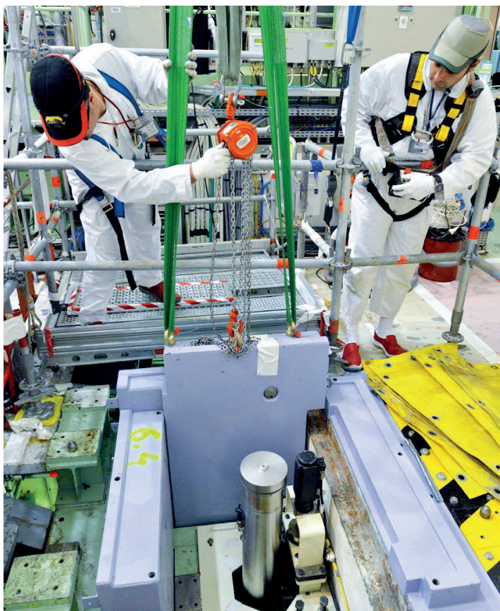
Mise en place d'une protection biologique dans l'enceinte du réacteur de recherche Cabri, 2012.
