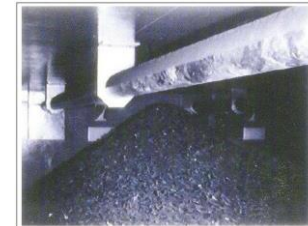
Fosse d'entreposage MAR 400 (Marcoule)
